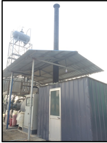
图 2-3 导热油炉燃料燃烧废气排气筒实景
